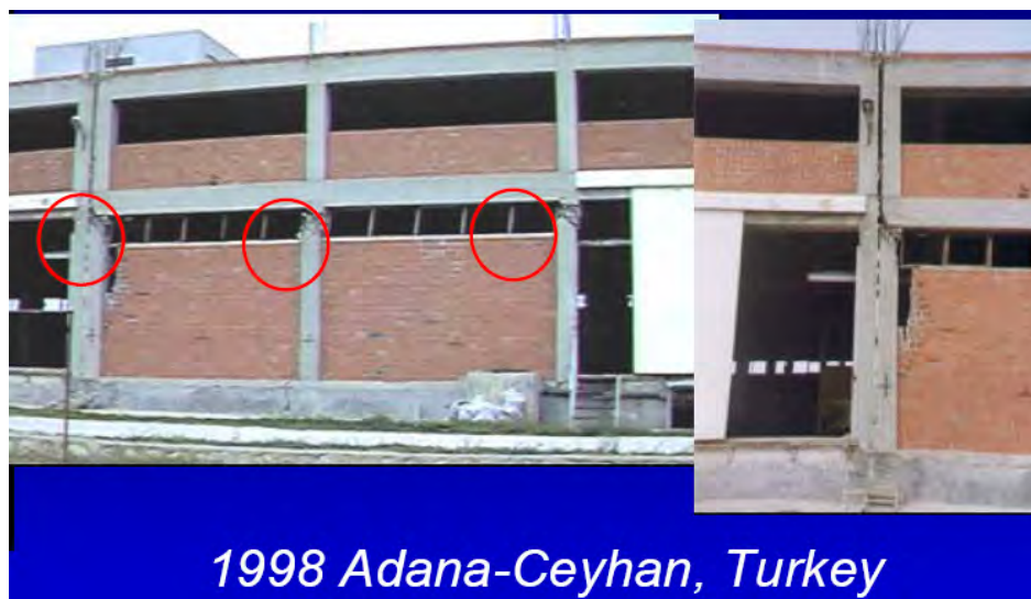
COLONNE TOZZE PER TAMPONATURA NON A TUTTA ALTEZZA
