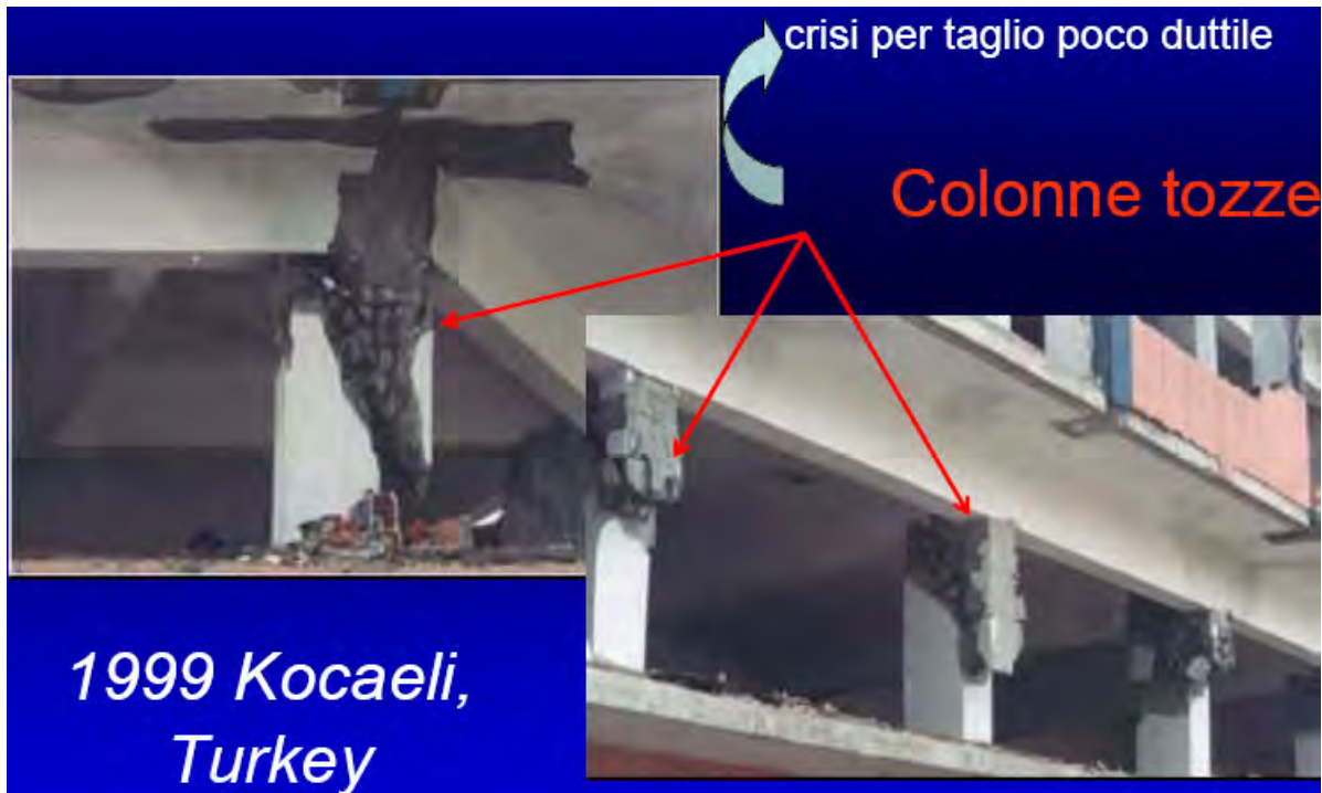
ROTTURA DI COLONNE TOZZE
