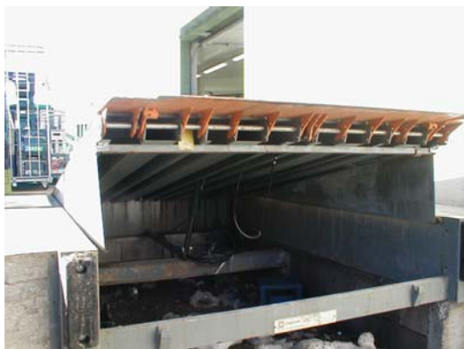
Rampa di carico motorizzata
