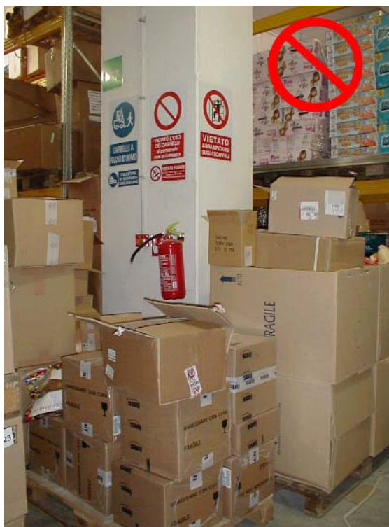
Scorretta disposizione dei materiali
