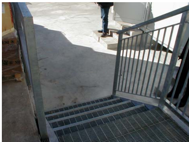
Scale sgombre da materiali
