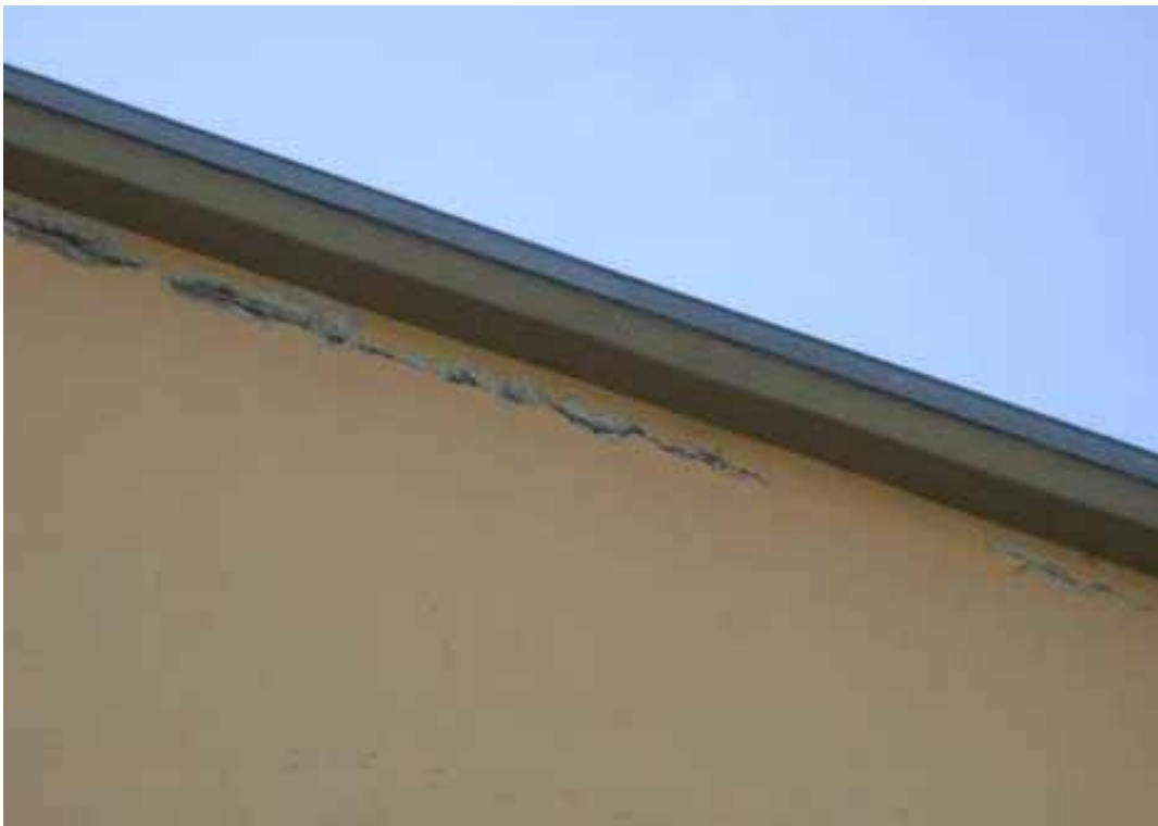
Figura 10. Lesioni di distacco tra il cordolo della copertura e la parete in muratura (by B. Calderoni, E. Cordasco, L. Migliaccio)
