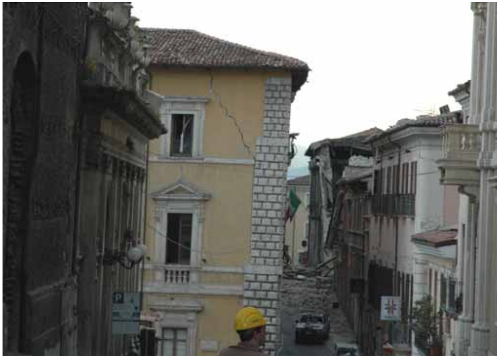
Figura 5. Lesione in pannello murario di sommità dovuta ad attivazione di meccanismo di ribaltamento fuori dal piano del paramento ad esso perpendicolare, grazie al buon ammorsamento nello spigolo (by A. Balsamo, I. Iovinella, A. Prota)
