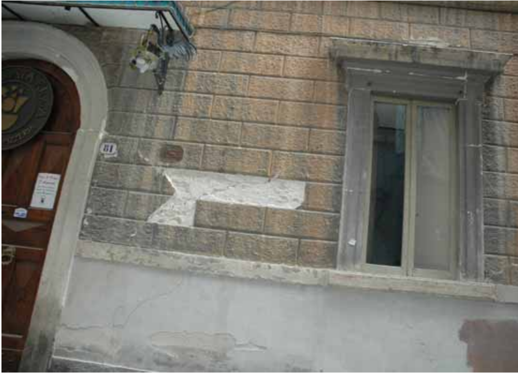
Figura 9. Lesione in un pannello murario di facciata (by A. Balsamo, I. Iovinella, A. Prota)
