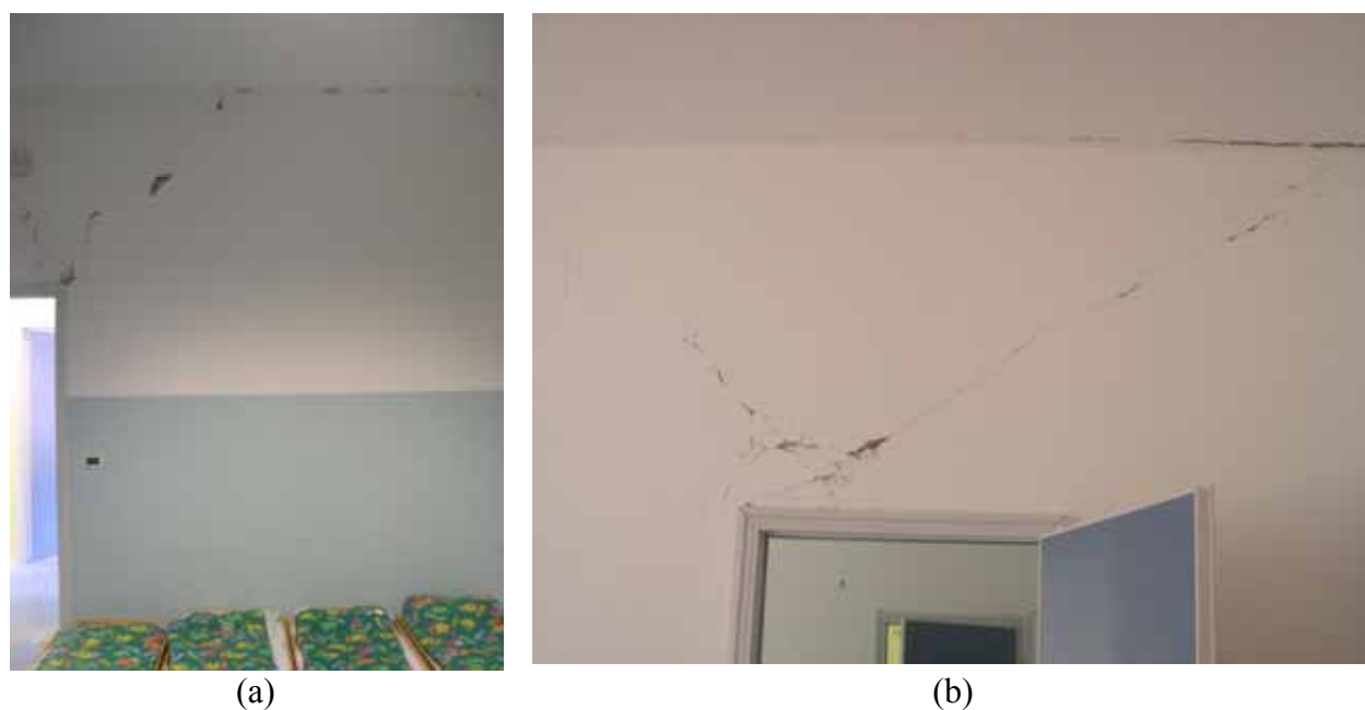
Figura 16. Danni alle partizioni: a) Lesioni all'attacco tramezzatura-trave ed in corrispondenza delle aperture; b) Lesioni sulla porzione sovrastante l'apertura (by F. Ceroni, M. Di Ludovico, A. Romano)
