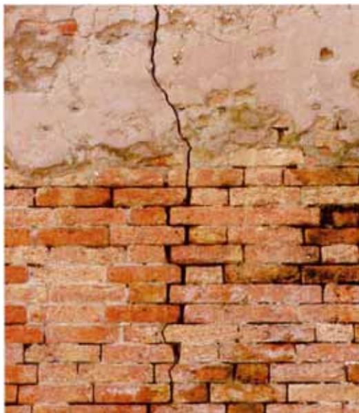
Figura 74. Paramento murario danneggiato su cui verrà realizzato intervento di scuci e cuci
