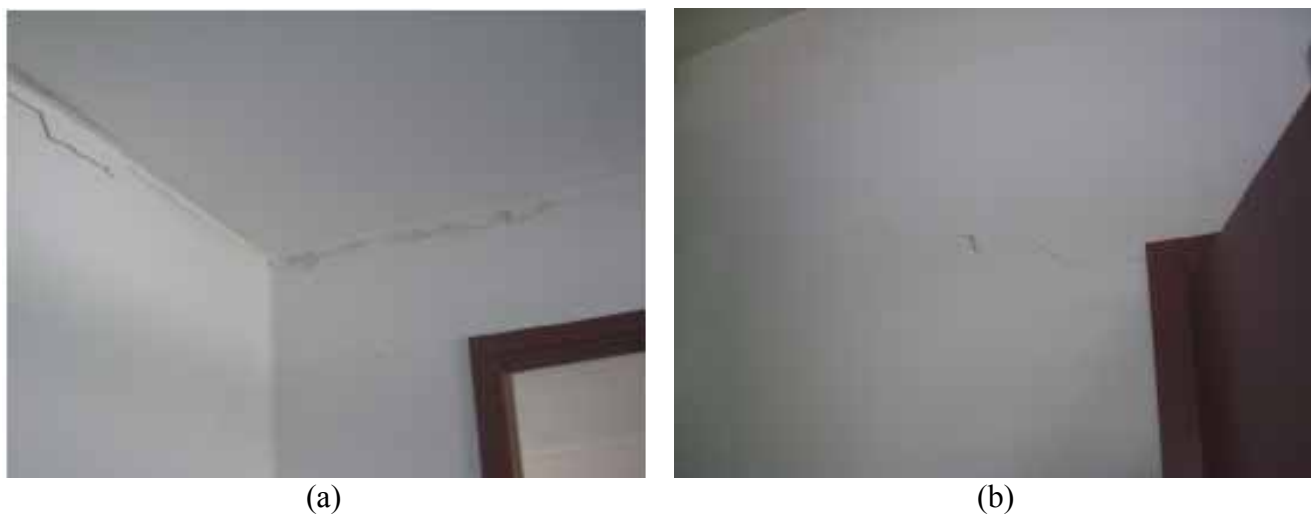
Figura 15. Danni alle partizioni: a) Lievi lesioni attacco tramezzatura-trave con parziale distacco intonaco; b) Lievi lesioni sui tramezzi in corrispondenza delle aperture (by D. Abbruzzese, R. Vittorini, F. Destefano, L. Miccoli, Z. Quian)
