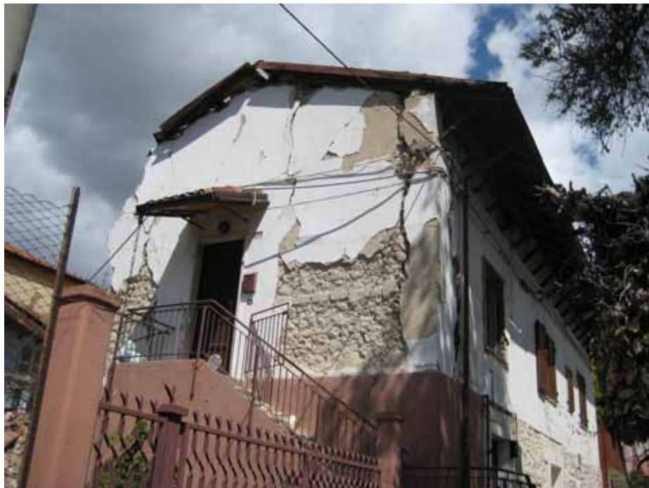
Figura 6. Lesione nel cantonale di un edificio in muratura (by A. Balsamo, I. Iovinella, A. Prota)
